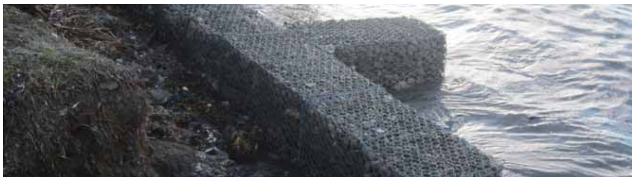
Première étape de construction du mur en gabion, qui doit limiter l'impact des ondes de tempête sur le littoral. Crédit photo : World Vision Îles Salomon.
