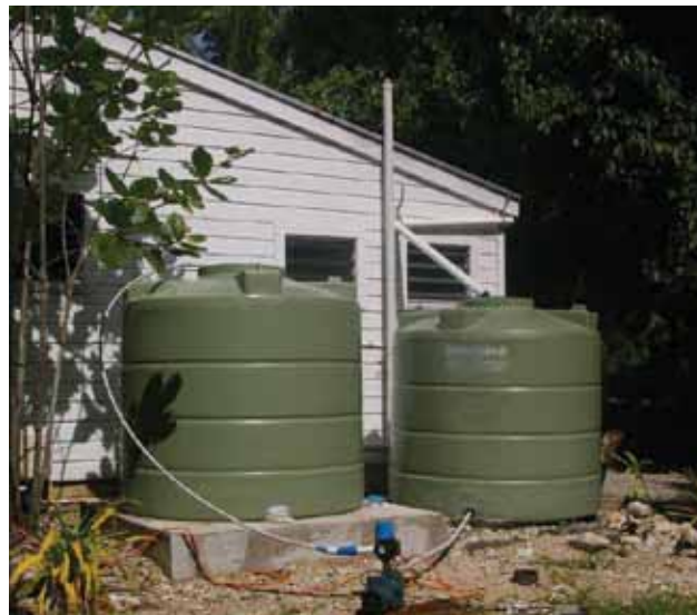
Citernes, gouttière et conduites installées sur une maison dans le cadre du projet PACC.
