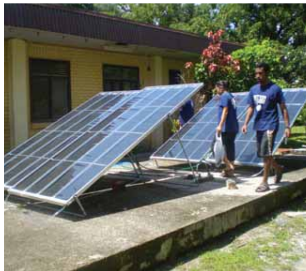
Panneaux solaires destinés à alimenter les purificateurs d'eau à Nauru.
