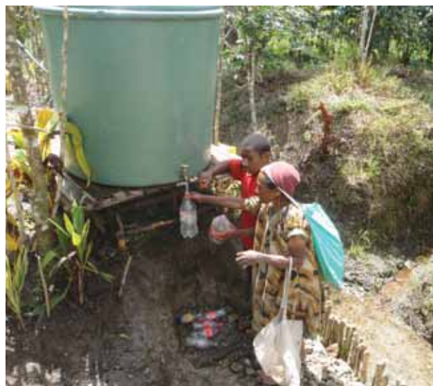
Des jeunes volontaires construisent un aqueduc en bambou, mars 2010. Crédit photo : Waqaniburotu, FICR.
