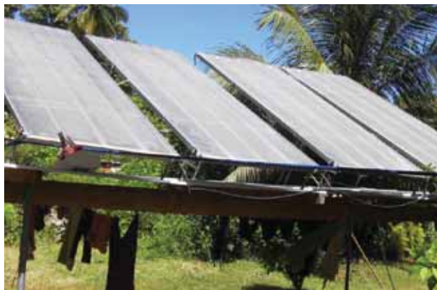
Panneaux solaires destinés à alimenter les purificateurs d'eau à Nauru.
