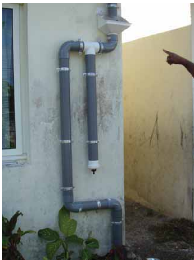
Raccordement résidentiel nouvellement installé en Nouvelle-Calédonie.
